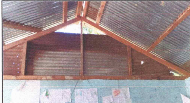
Foto: 4 sustitucion de laminas por laminas troqueladas, de madera por metal costaneras
